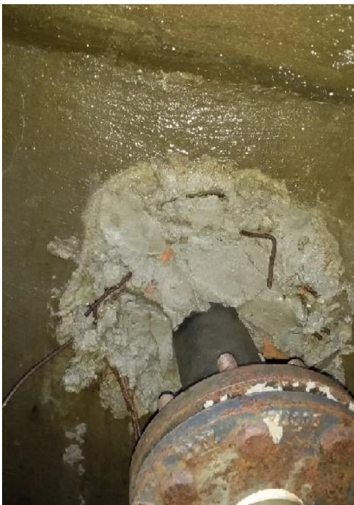
Identificação de ponto de vazamento
